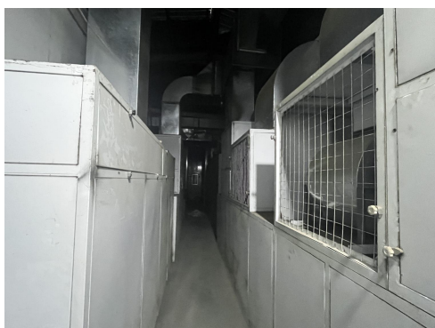
图 7-1 废气处理设施进口现状
