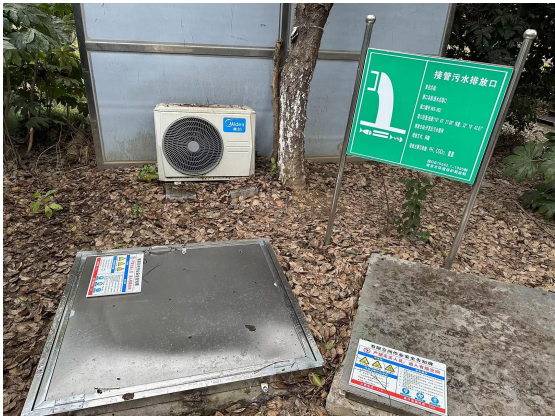
图 3-3 污水排口标识
