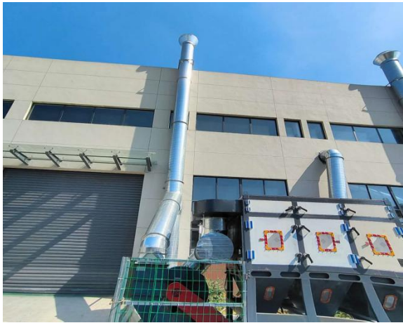
布袋除尘器+15m 高排气筒
