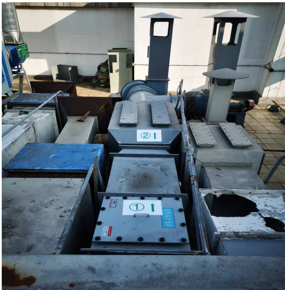
二级活性炭吸附+99m 高排气筒（FQ-01）
