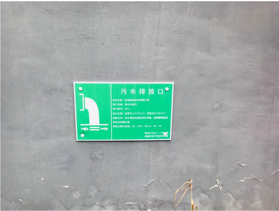
污水排口标识
