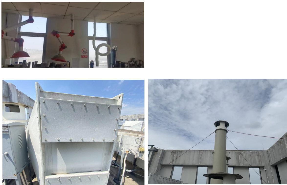
图 3-2 废气处理设施
