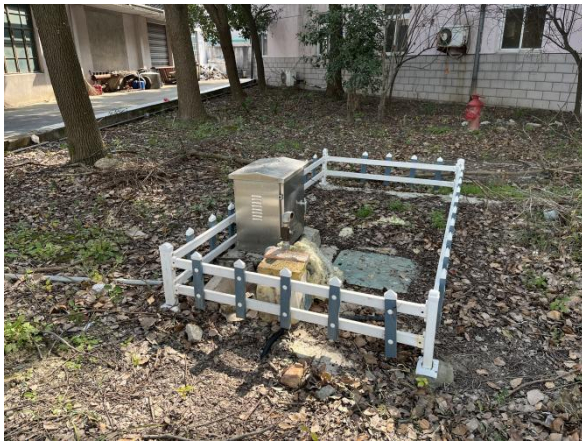
图 3-4 厂区分散式地理污水设施处理
