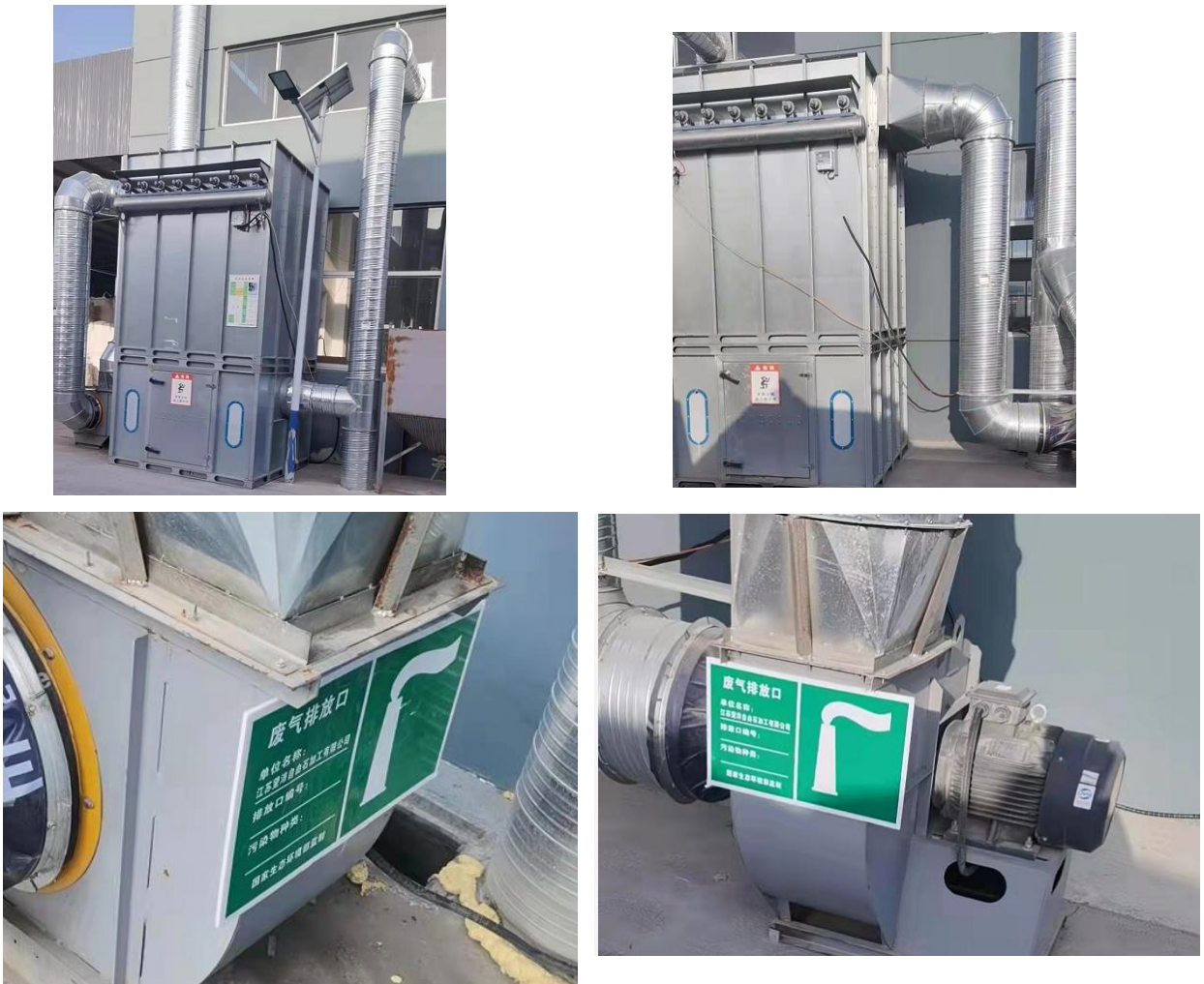
图 4.1-5 车间废气处理设施及废气标识
