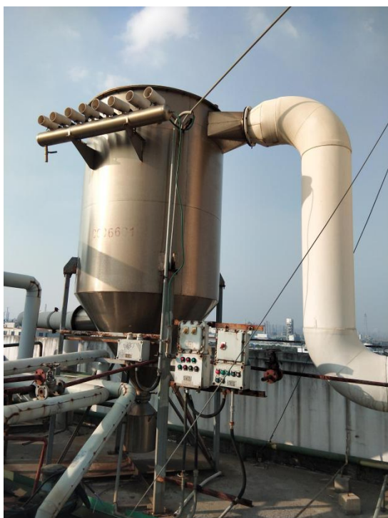
多功能加工二车间：布袋除尘+喷淋+排气筒 废气处理装置装置及排气筒标识
