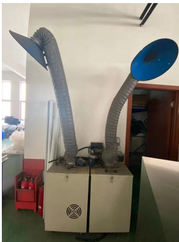
图 3-1 移动式焊接烟尘除尘器
