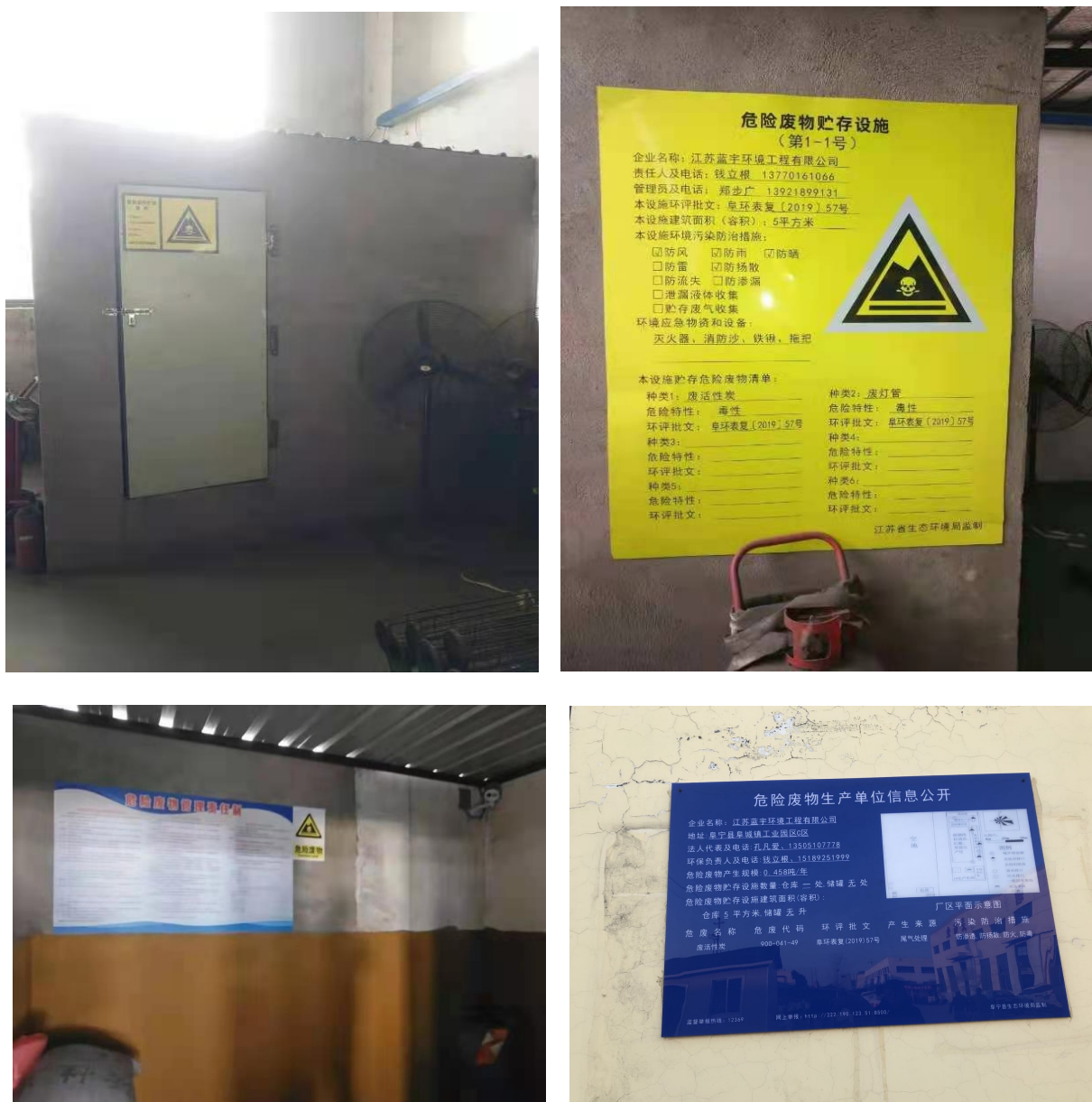
图 4.1-9 危废仓库及标识牌
