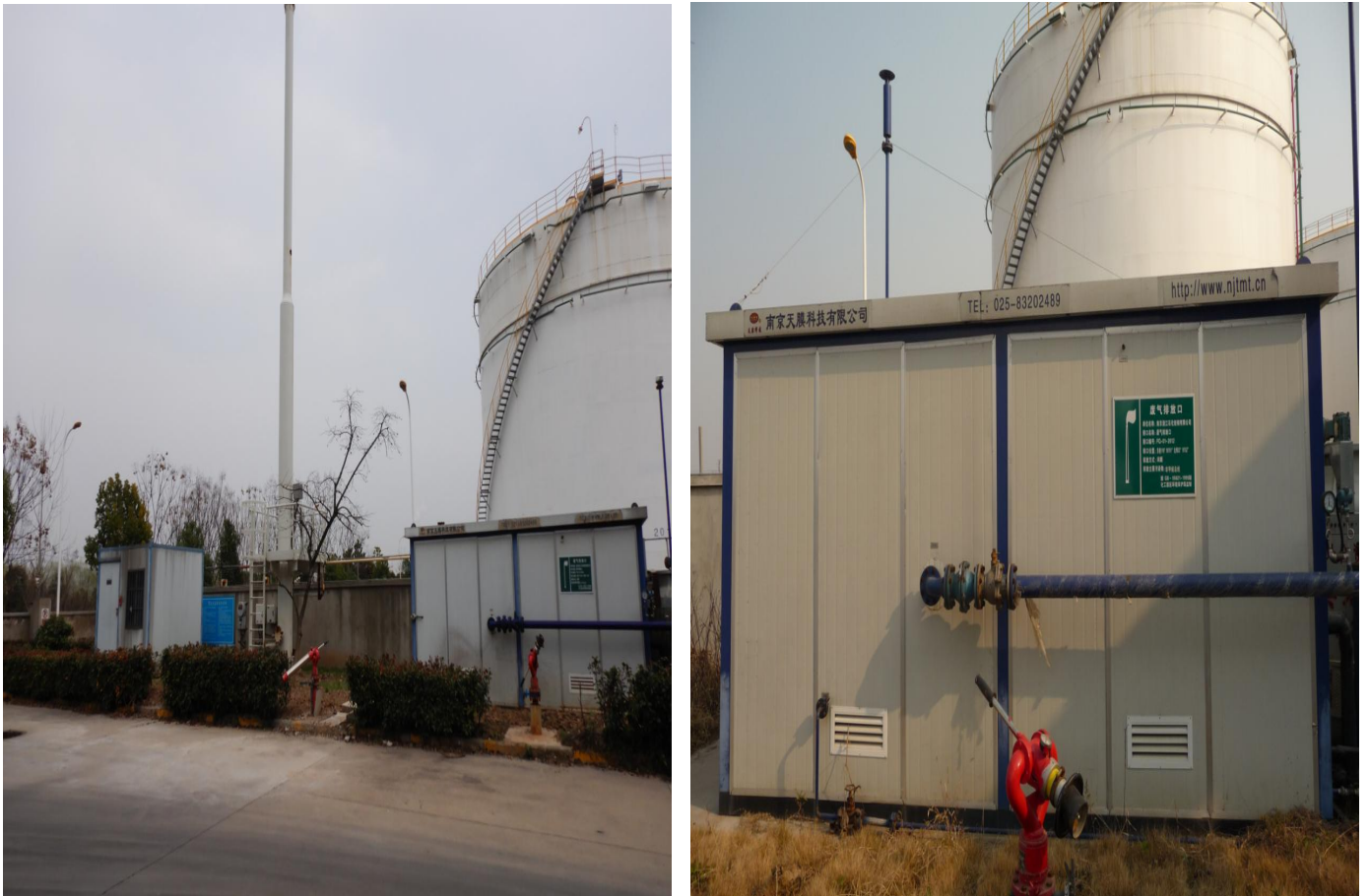
图 4.1-6 油气回收装置及排气筒标识
