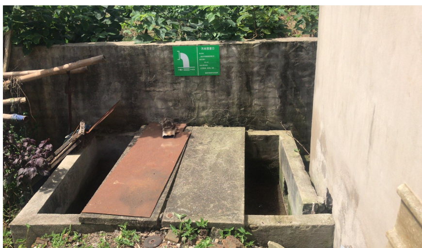
图 3-2 生活污水处理设施
