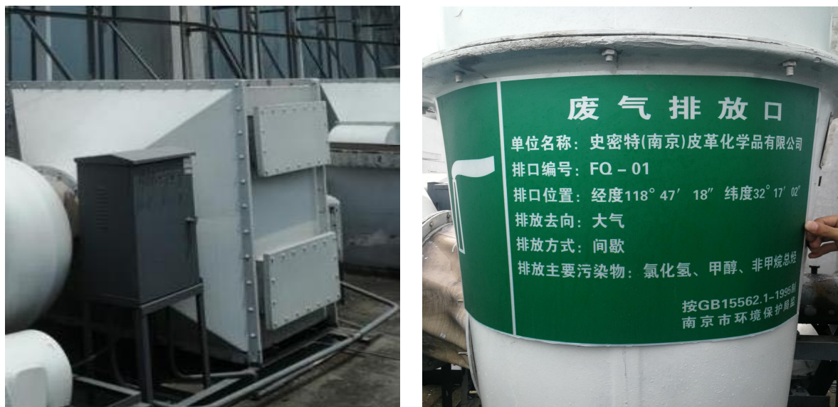
图 3-3 废气处理装置及排口标识
