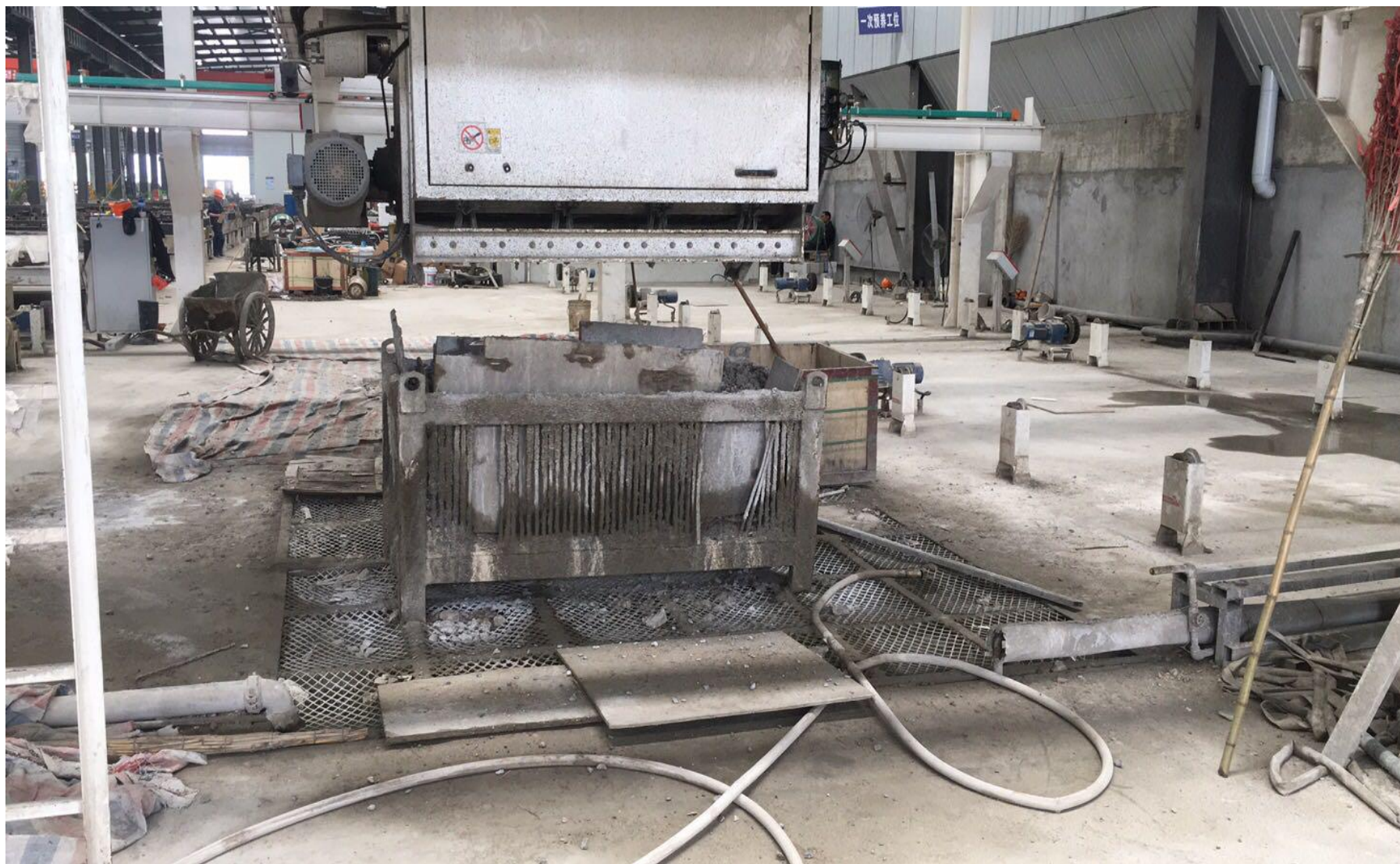
图 4.1.2 污水处理设施现场图
