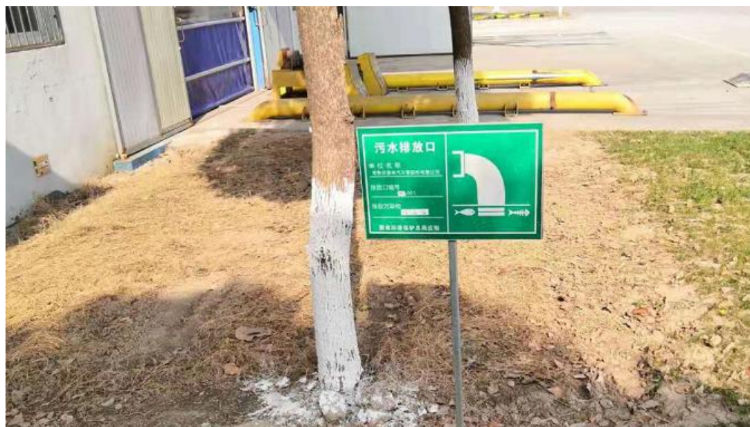
图 3-2 生活污水处理设施及排口
