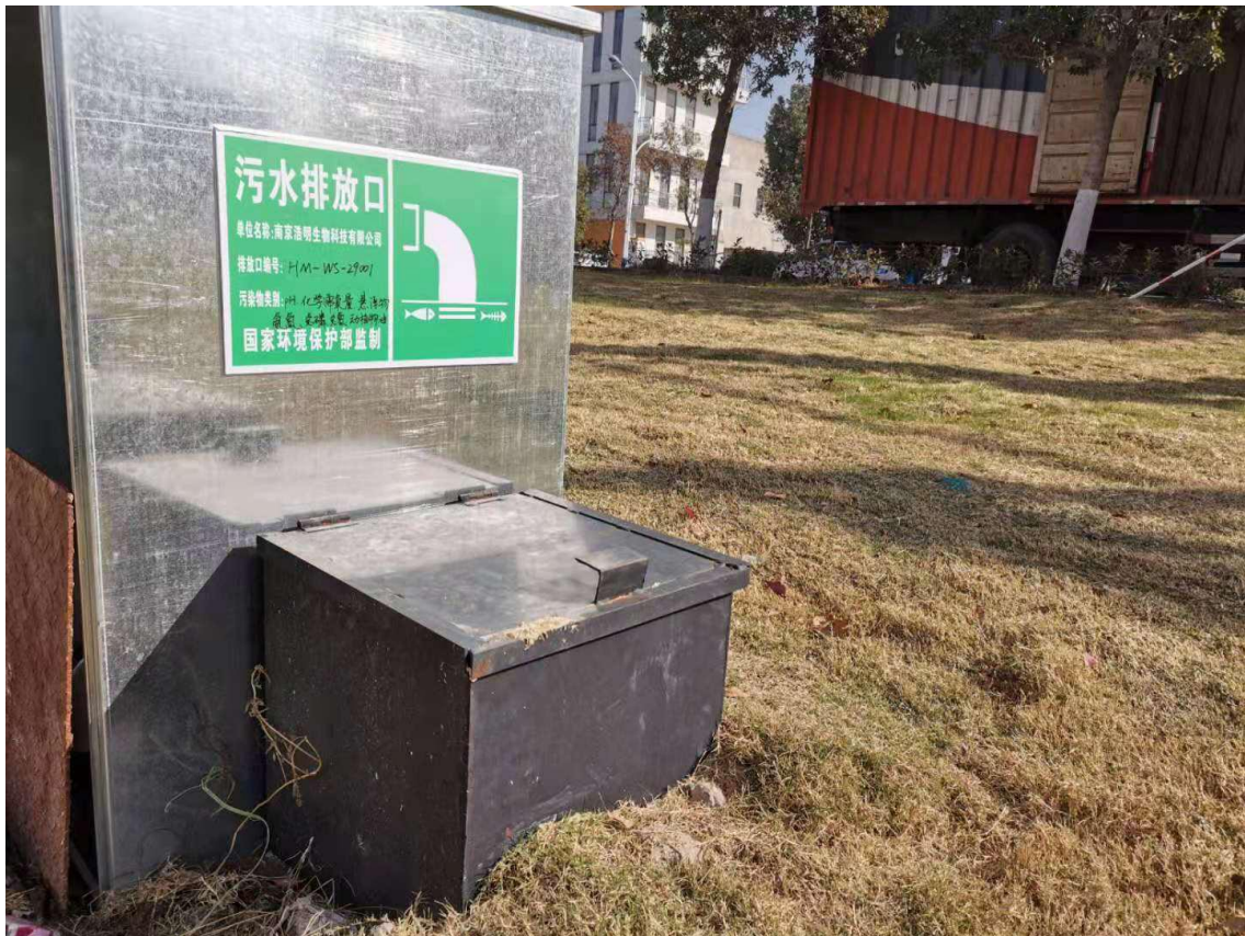
废水排口（地下为 SBR 污水处理设施）
