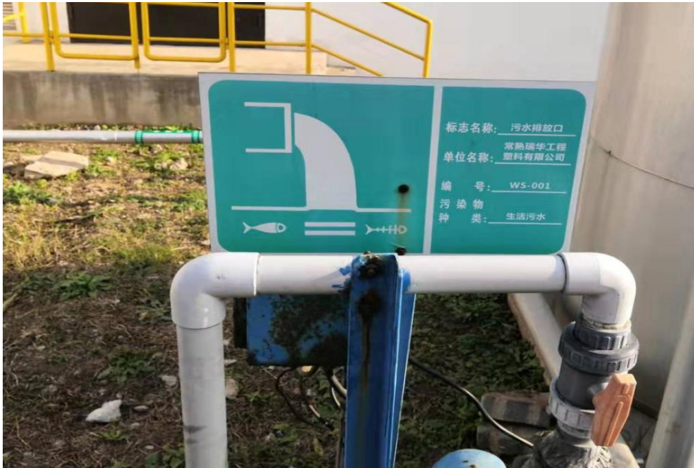
图 3-2 生活污水处理设施及排口
