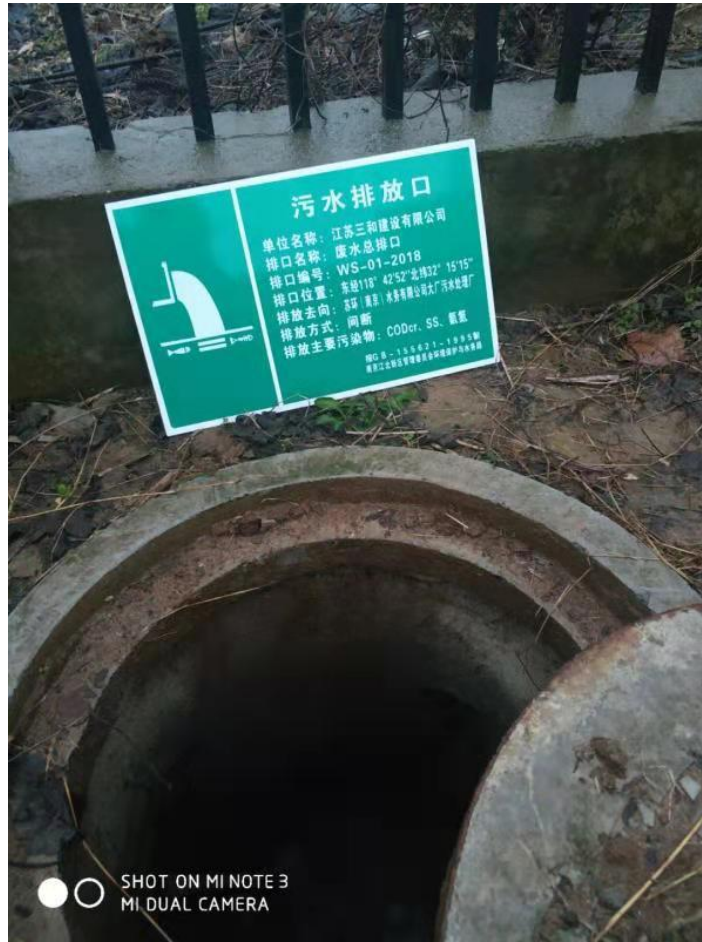
污水排口（依托租赁方）
